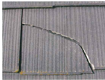
斜め割れ (下部分)
