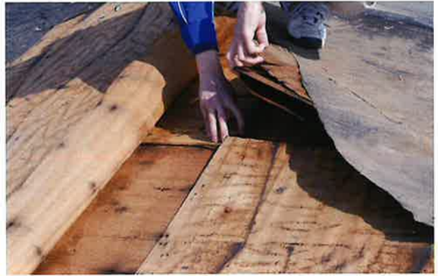
下地材（屋根の下にある木材部分）が腐朽している。
