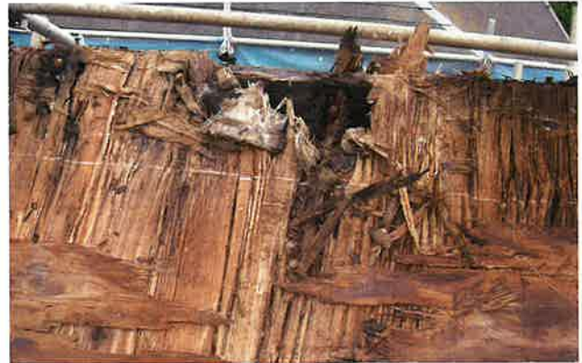
下地板および屋根垂木（下地材を支えている部分）の腐朽。
