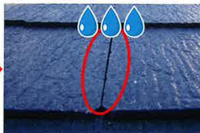
縦の隙間から雨水が浸入する
