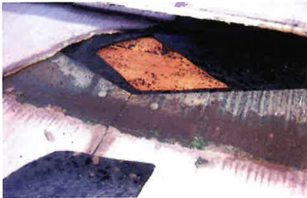
完全に腐朽し、塗装によるリフォームができなくなっていた。
