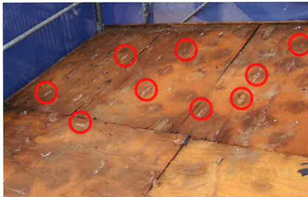
下地材、釘廻りの腐朽（赤丸部分）
