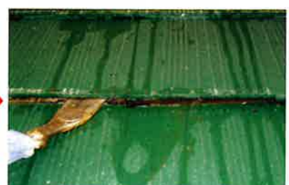
持ち上げると中から雨水が出てくる
